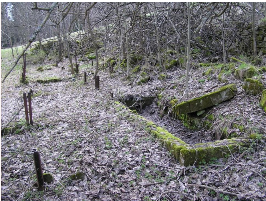
obr. 33 – Stará Hůrka – zbytky nádrže na vodu u domu č. 70, autor Martin Čejka
