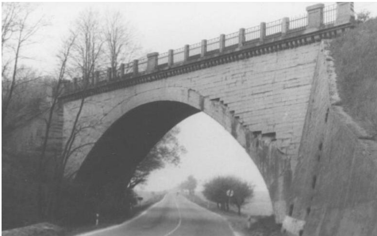
obr. 11 – železniční most přes silnici I/56 v havarijním stavu počátkem 90.let 20.století (Zdroj: Josef)
